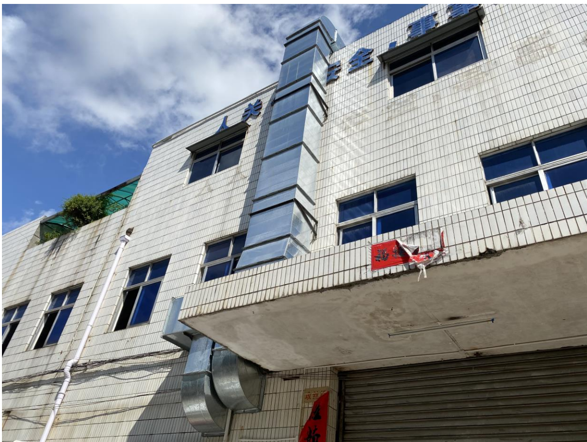
印刷废气收集管道
