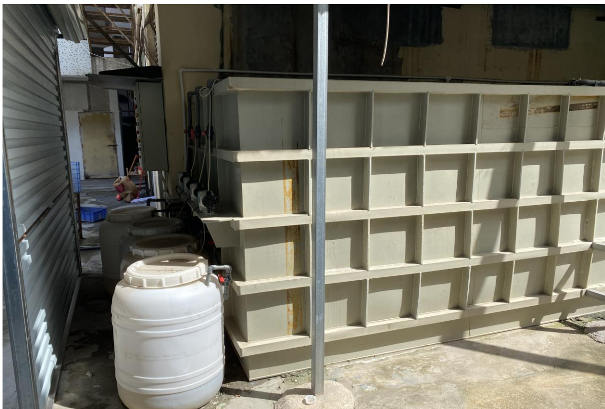
项目污水循环回用设施
