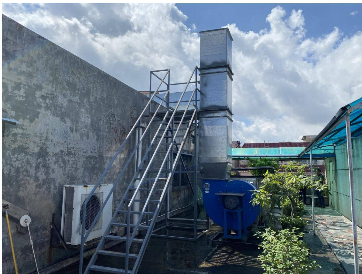
项目废气有组织排放排气筒
